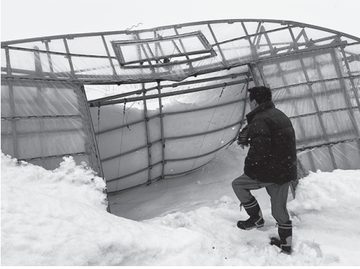
大雪で倒壊した農業用パイプハウス(柏地区) ＝総務経済建設常任委員会による被害状況調査、2月6日
