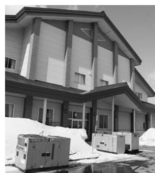
避難所への発電機設置
