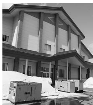
避難所への発電機設置
