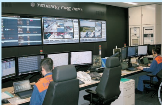
導入された高機能消防指令システム
