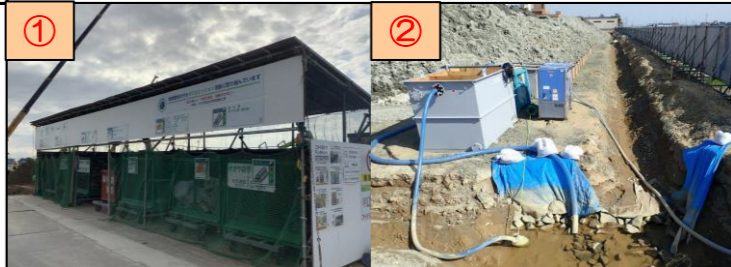
産廃分別ヤード 中和装置を通しての放水
