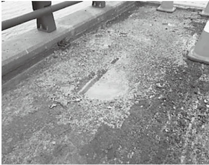
写真-1 床版上面損傷状況
