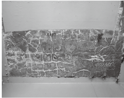
写真-2 床版下面損傷状況
